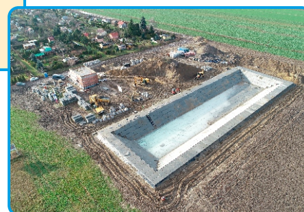
Wielki zbiornik awaryjnego zrzutu wody w Chojnach
