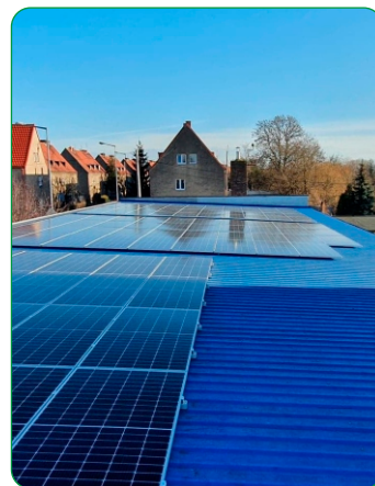
Panele fotowoltaiczne na dachu Stacji Uzdatniania Wody
