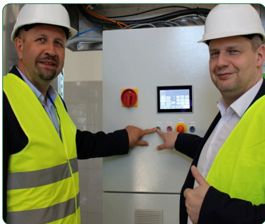
Próbne uruchomienie nowoczesnej instalacji do przetwarzania odpadów w kolskim MZWIK
