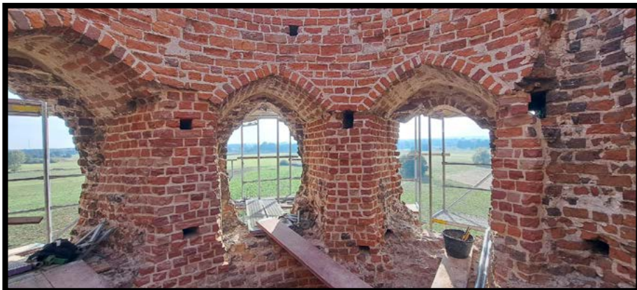
Typowe dla gotyku ostrołukowe otwory okienne wieży narożnej wymagały interwencji.
